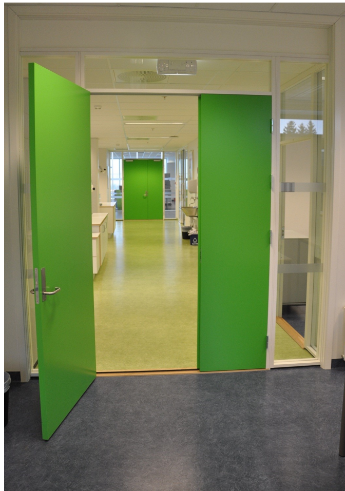
Dørene har elektrisk sluttstykke, karmoverføring og automatskåter.
